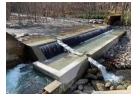
国有林野を利用した小水力発電所
